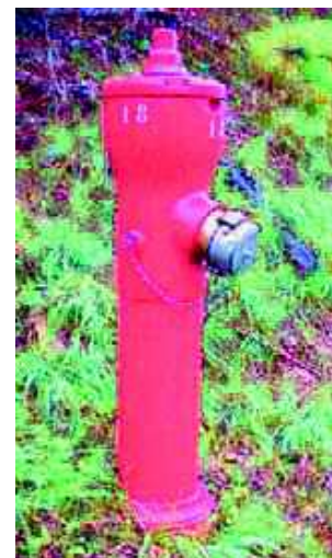
Poteau incendie de 80mm avec une sortie de 65mm
