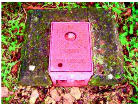
Bouche de lavage fermée
