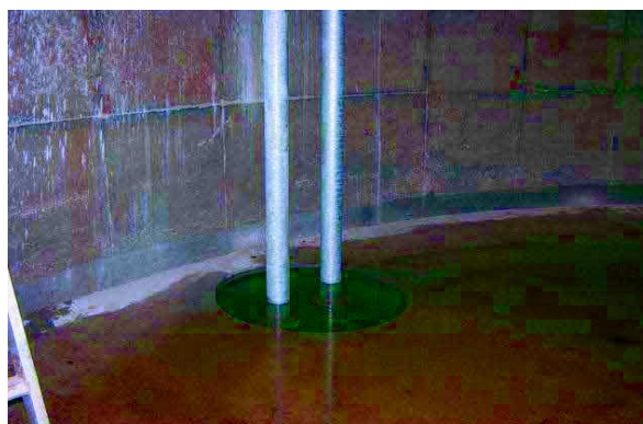
Fond de la cuve avec crépine sous le niveau le plus bas de l'eau
