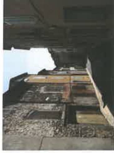
Constructions avec implantation des façades sur la rue. Les façades sont hétérogènes, plus ou moins dégradées, avec pierres apparentes ou non. D'autres ont été rénovées et enduites dans des tons jaune foncé. Le bâti se caractérise par des constructions sur trois niveaux
